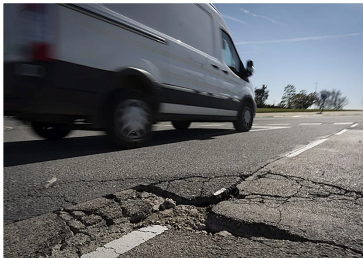
Estado de una carretera tras el paso del temporal por Madrid. (MATÍAS NIETO)
